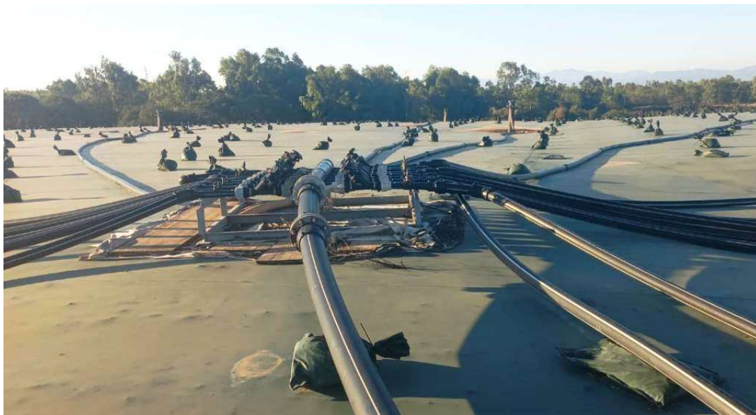
Stazione di regolazione del biogas
