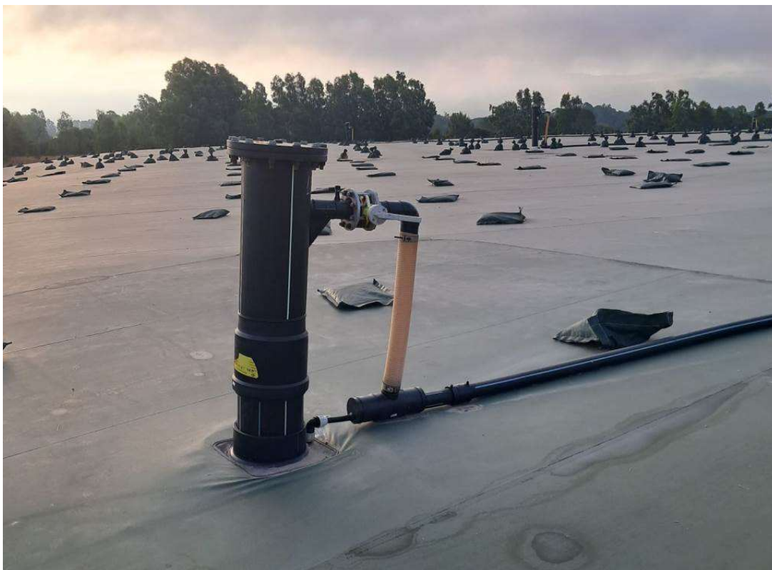
Testa di pozzo biogas emergente dalla copertura
