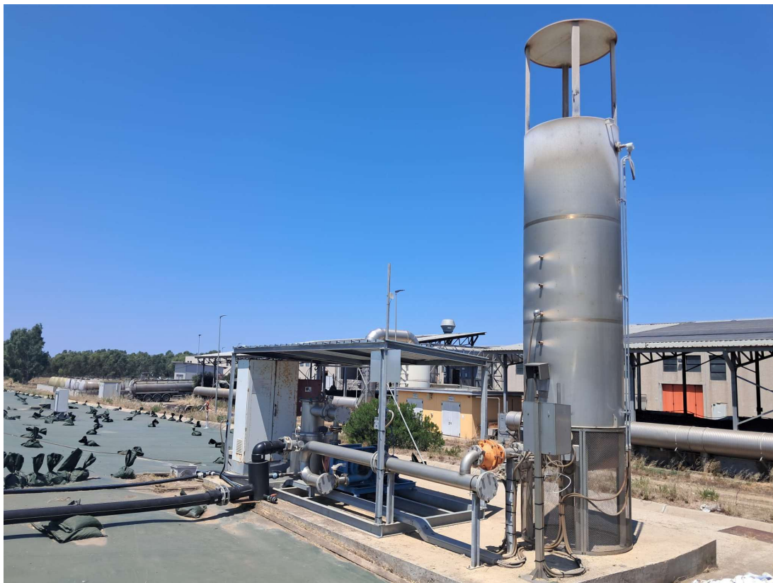
Centrale di Estrazione del biogas
